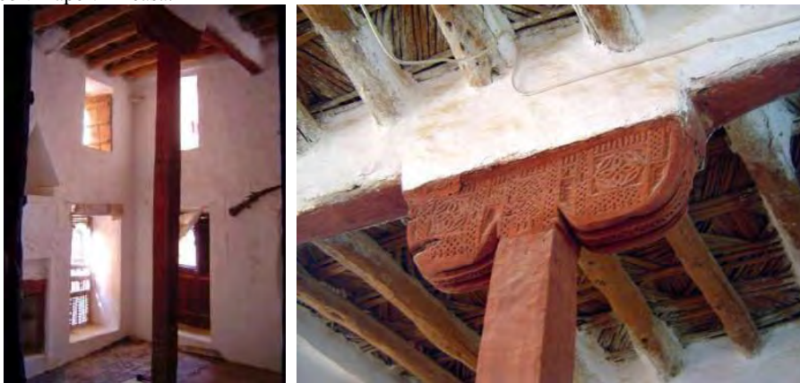
Fig. 6 Interni, in cui si vede la colonna rompi-tratta delle travi portanti dei solai e il 'capitello' di ripartizione dei carichi.
